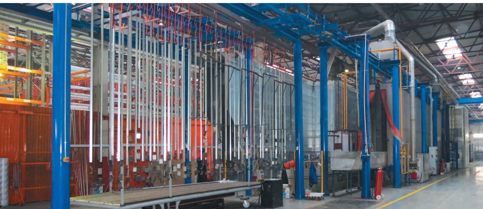
РОССИЯ, НОВОСИБИРСК. Автоматическая линия порошковой окраски металлических конструкций
